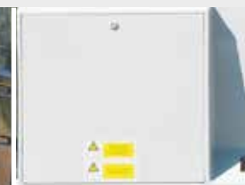
9 Quadro elétrico centralizado, localizado no interior de um armário estanque e de fácil acesso.
